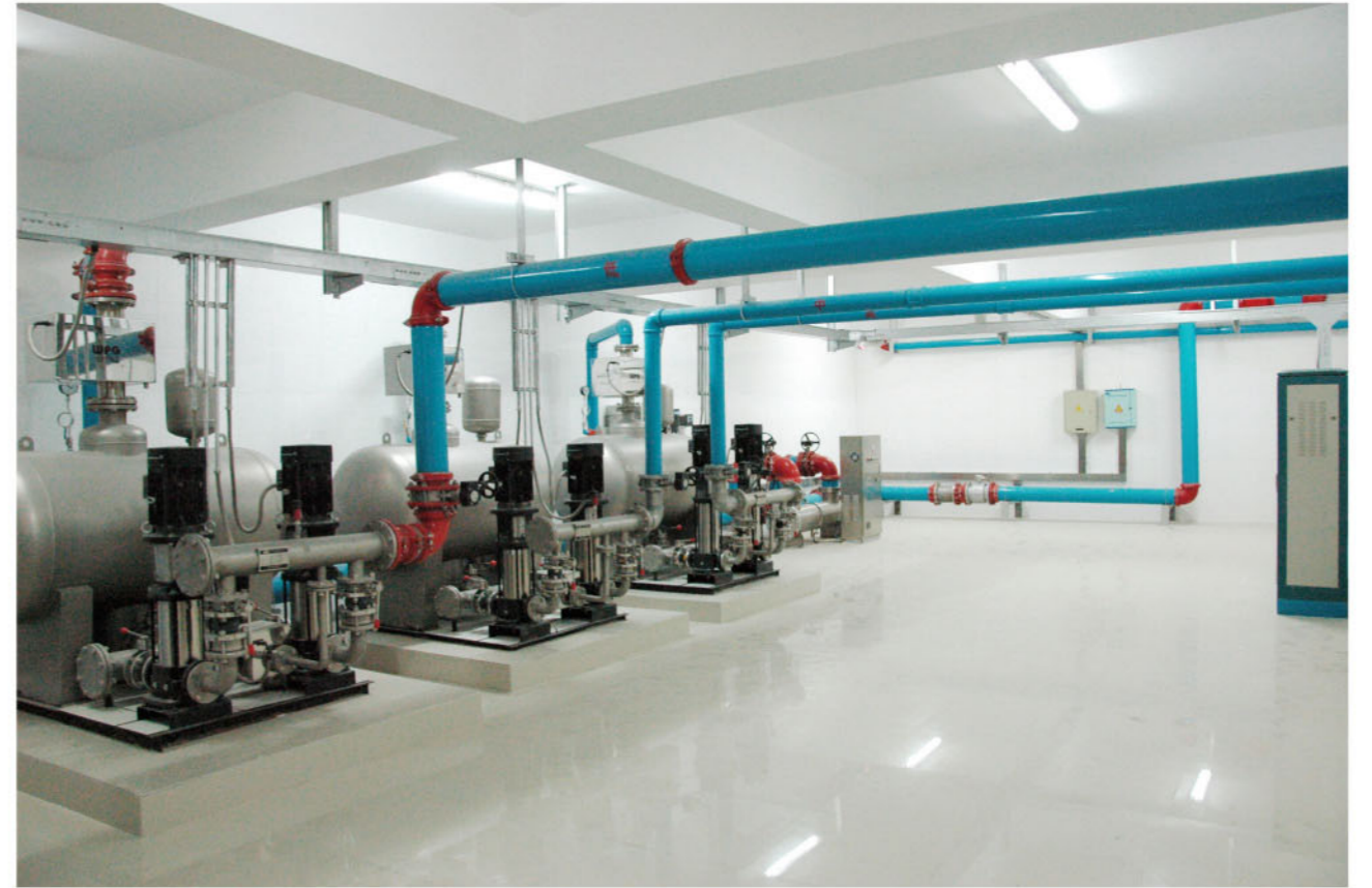
图1、二次供水运行设施
