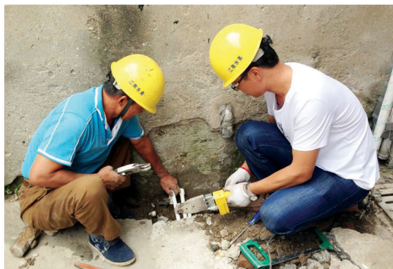
安排在晚上22点以后，施工人员挑灯夜战赶进度。二是精准操作。老小区管线错综复杂，架空线路及各种构筑物影响作业环境，工作人员克服困难，在狭小的空间内精心操作。三是加强沟通。为缩减停水时间，工程采用新老水管同时供水方案，改好一户通一户，确保每户水表改装到位，让用户满意。（高飞）
